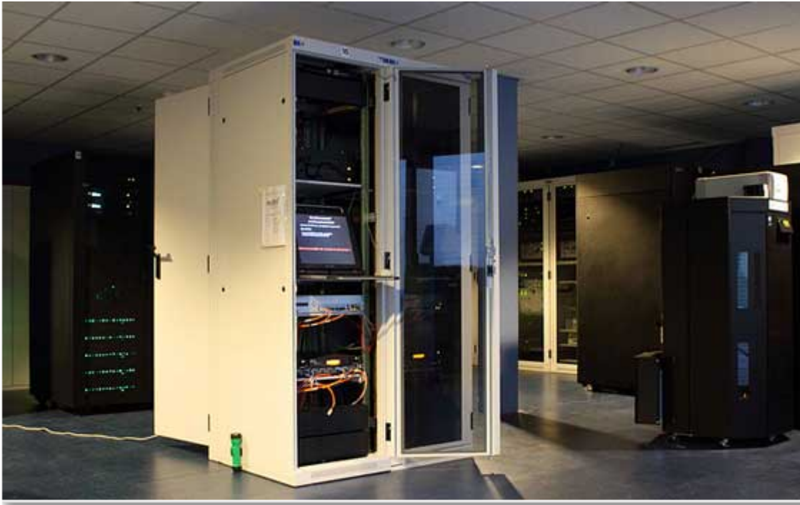
Baie de brassage en Data Center
